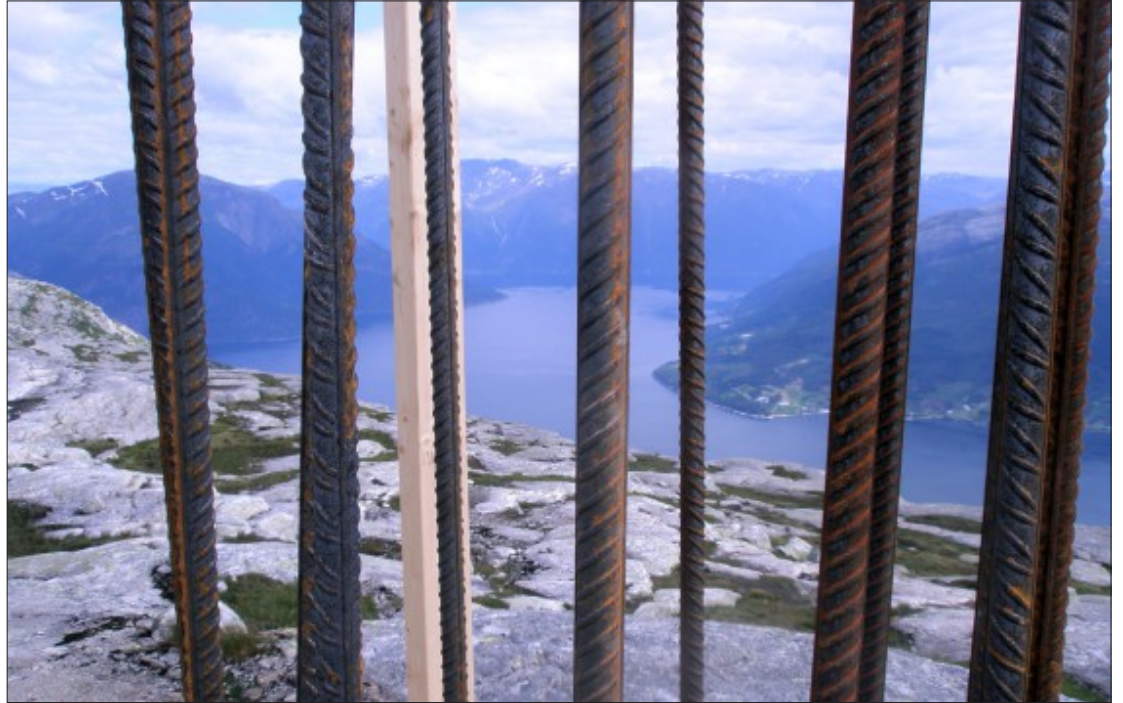
SIMA-SAMNANGER: Det er ikkje grunnlag for å hevda at ein må ha lina Sima-Samnanger for å sikra straumforsyninga til Bergen i 2012, skriv innsendaren. Bildet syner bygging av mastefundament ved Hardangerfjorden. ARKIVFOTO: ØIVIND RAKNES
